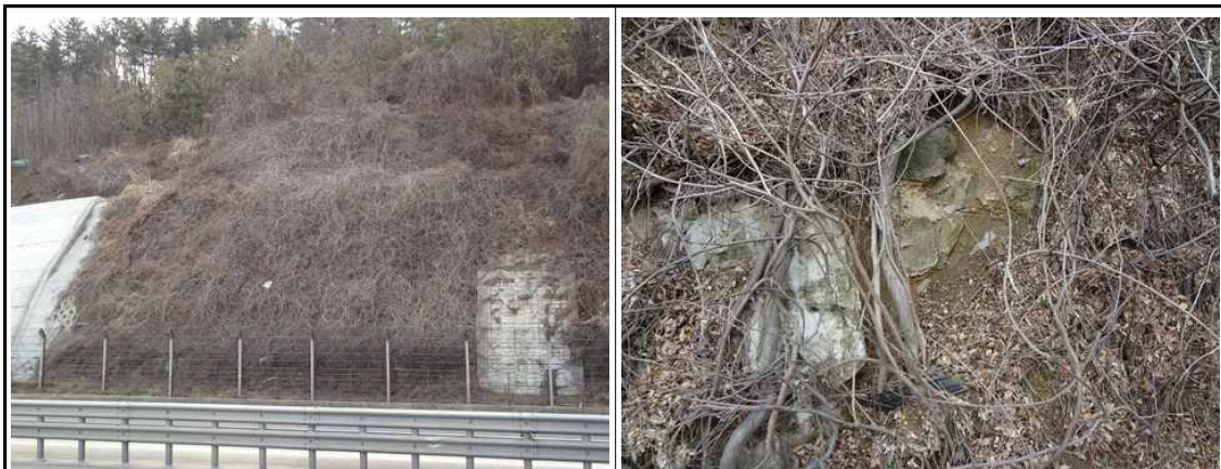
① 13.73K 1단 이완암, 표층유실, 누수 ⇨ 주의관찰 후 조치
